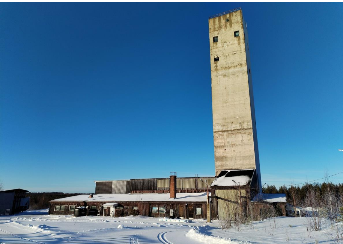
Kuva 46. Kaivostorni ja sen yhteydessä oleva rakennus. Kaivostorni on betonirakenteinen ja ulkomuodoltaan pelkistetty. Tornia ympäröi matala, lapekattoinen rakennus, jonka julkisivut ovat puuta ja peltiä. Rakennuksessa on mm. toimistotiloja, teollisen toiminnan tiloja ja varastotiloja. Ulkoasusta päätellen rakennusta on muutettu ja laajennettu useassa eri vaiheessa.
